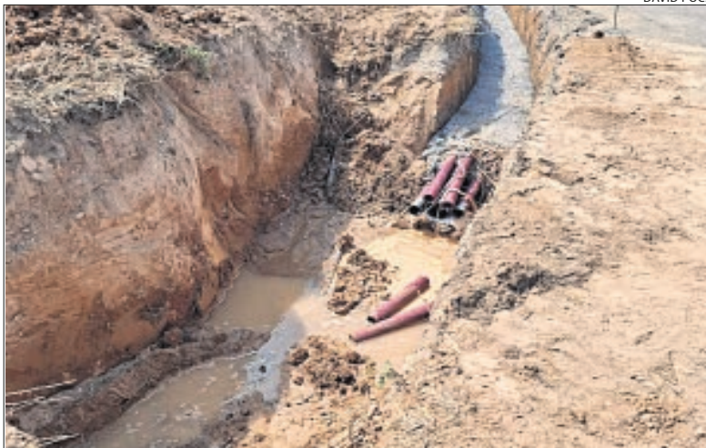
Reventón en una tubería de l'Horta.
